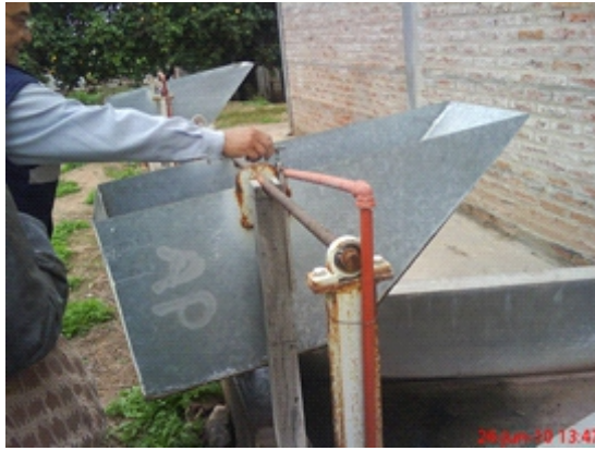
Sistema automático x gravedad de lavado de fosas - Las Breñas.
