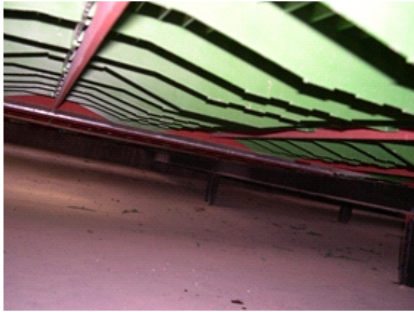
Sistema de sujeción del piso de eslat sobre la fosa - Corrientes.
