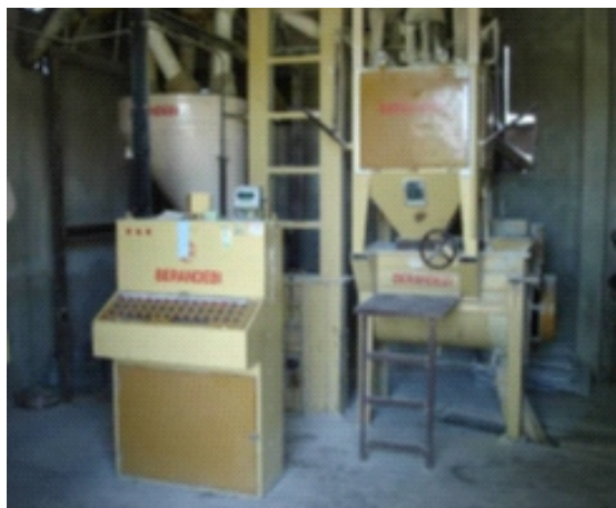
Módulo de comando eléctrico, balanza con cabezal electrónico, tolva de molienda, mezcladora horizontal, noria elevación, roscas de alimentación materia prima cada silo.
