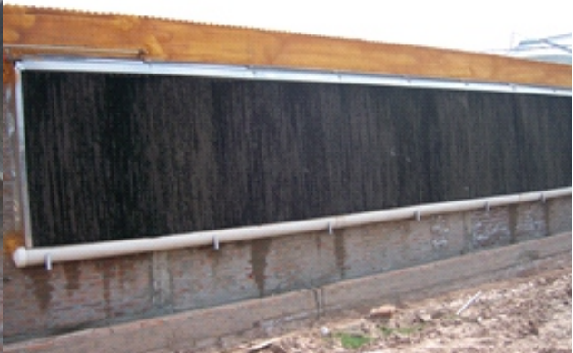
Paneles de refrigeración nave gestación - Sáenz Peña, Chaco.
