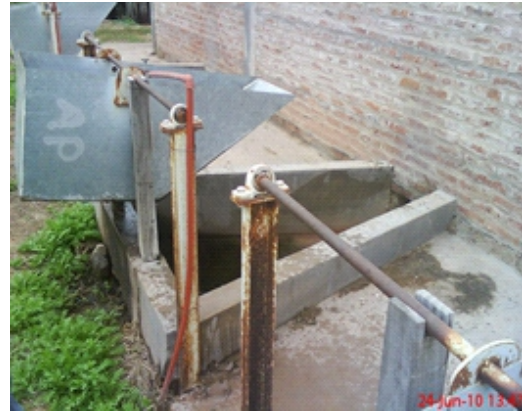
Sistema de vuelco de agua por gravedad para lavado de fosas.
