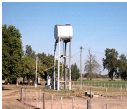
Tanque sobre elevado de agua sobre postes de quebracho colorado al borde de un pozo, carga con motor trifásico – 5000 litros - Las Breñas.
