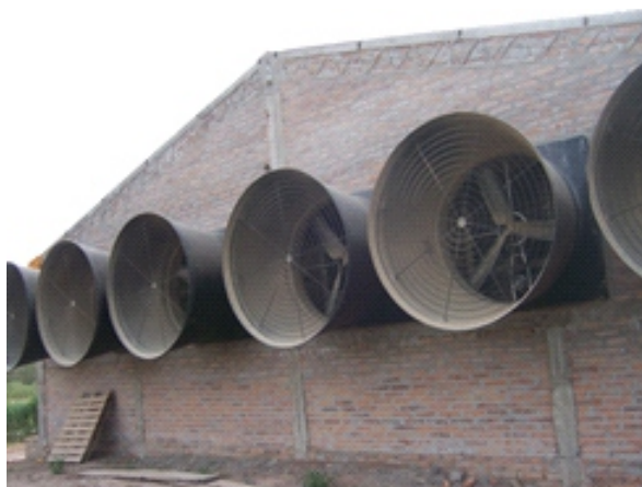
Sistema de ventilación forzada en galpón de engorde - Sáenz Peña, Chaco.
