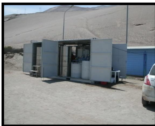
Figura 5. Planta de tratamiento móvil de por Osmosis Inversa. Proyecto ABAR
