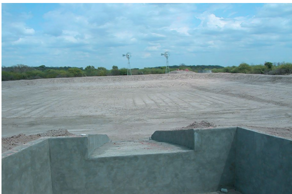
Trampa de sedimentos previa al ingreso del agua del área de captación al reservorio permite alargar la vida útil de dicha obra.
