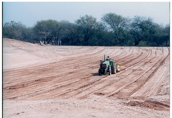
Construcción de una represa con tractor y pala de arrastre. maquinaria ideal para este tipo de obra.
