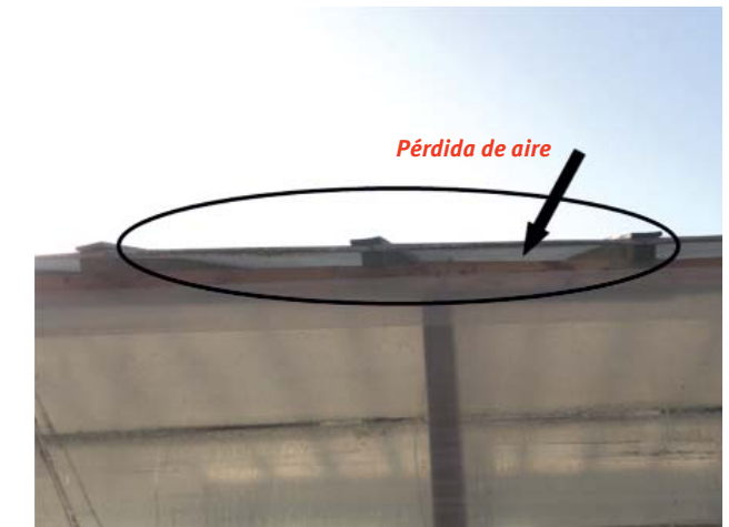
Figura 9. Evitar este tipo de aberturas en la unión del techo con las paredes.
