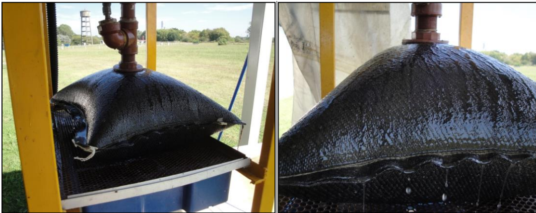
Figura 24: Filtración de efluente porcino a través de geocontenedores.
