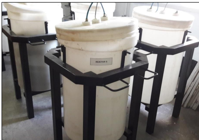
Figura 19: Reactores aeróbicos de 100 Litros
