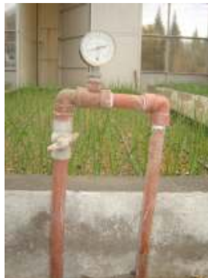
Figura 14 - Detalle de manómetro
