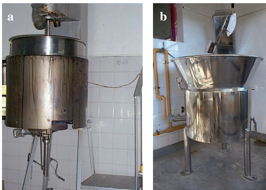
Figura 27: Paila abierta doble camisa y fluido de calefacción intermedio, calefaccionada con fuego directo. a) Instalada en altura (gentileza Establecimiento Masseur, El Hoyo - Chubut). b) Instalada al nivel de piso (gentileza Chacra Cuyén, El Hoyo - Chubut) 37
