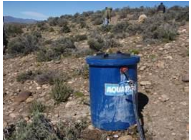
Foto 8. Tambor rompecarga para evitar sobrepresiones en el sistema que puedan romper cañerías y uniones de manguera.
