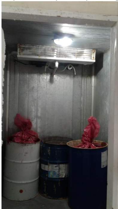
Figura 6. Cámara de frío para depósito de residuos biopatogénicos.
