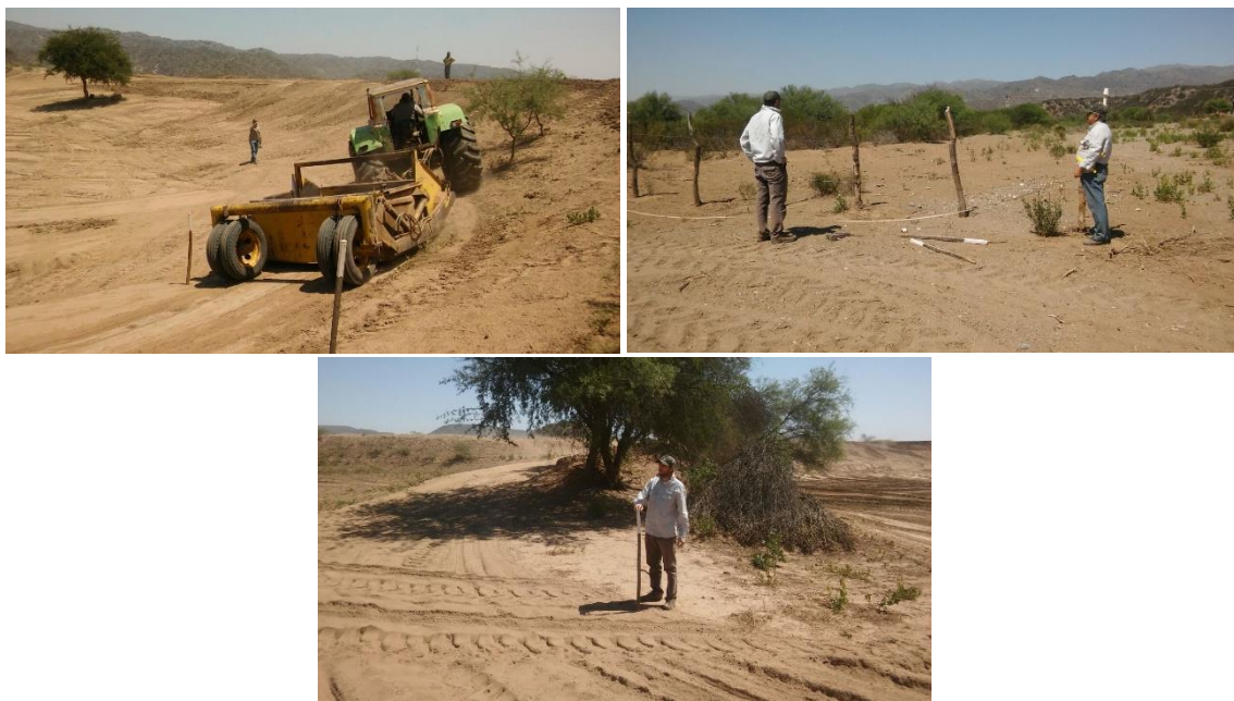
Figura 4: Definición de Bordos, Patio y Estructuras de Conservación Represa Comunitaria Baldes del Rosario, Valle Fértil.
