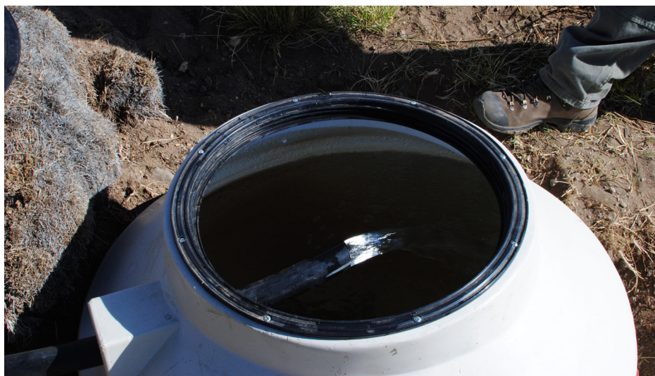
Figura 1. Tanque reservorio en red de agua rural - Área Natural Protegida Tromen (Norte de Neuquén).
