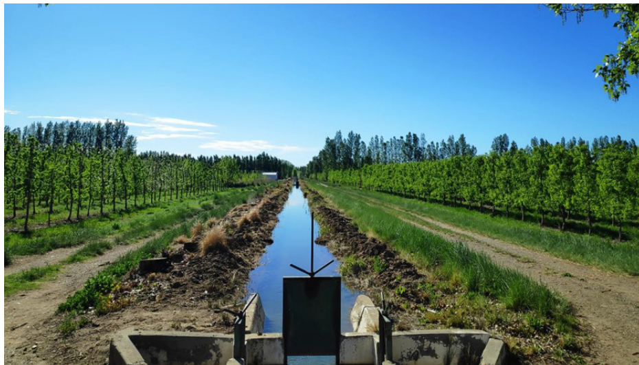
Figura 3. Canal de riego revestido en parcela de frutales de la EEA Alto Valle.
