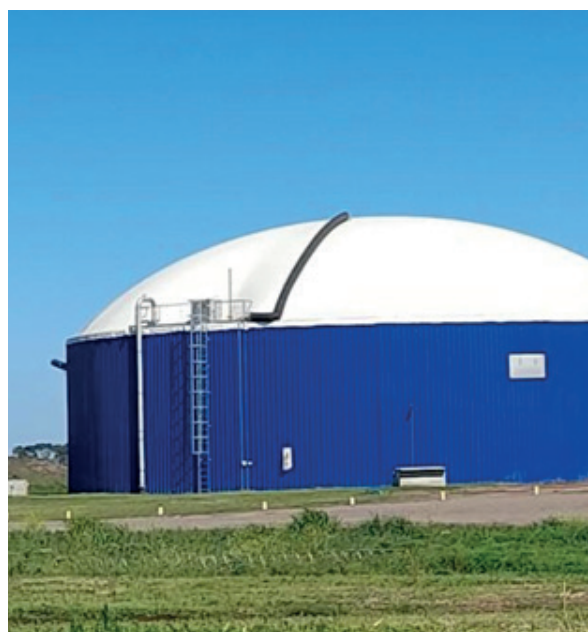
Figura 2. Reactores anaeróbicos (planta de biogas).
