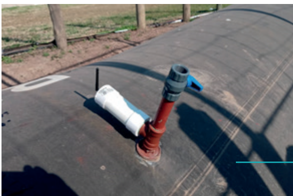
Figura 2. Sistema de monitoreo remoto.
