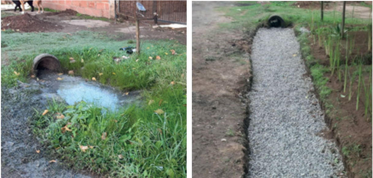
Figura 2. El antes y el después de la zanja o canal pluvial y el equipo de trabajo interviniente.
