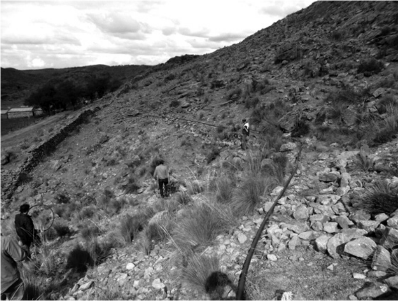
Figura 2. Conducción de agua por tubería
